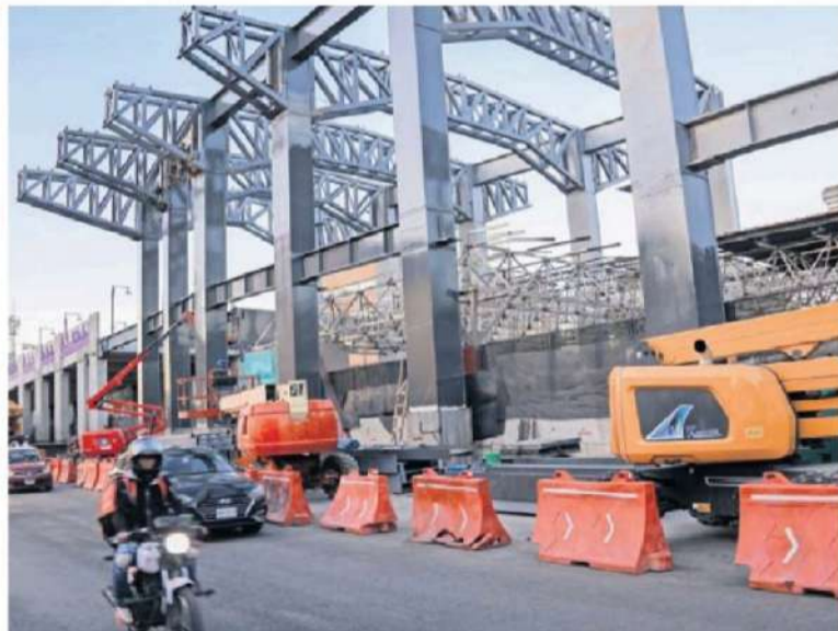
Los trabajos en la Línea 2 del Metro sobre la Calzada de Tlalpan aún se ven lejos de concluir, pese a que el campeonato está a la vuelta de la esquina.
